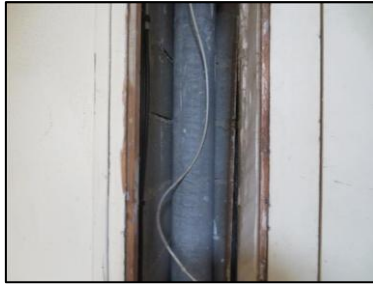
Photo N° 1071 AMIANTE CIMENT -- PLACARDS TECHNIQUES -1 à +4 Conduits de fluide Chute E.P.(Fibres- ciment)
